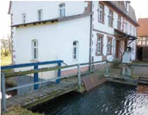
Abb. 1: Wasserkraftanlage Schmaleicher Mühle, vor der Modernisierung der Rechenanlage
